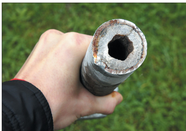
▲ Obr. 2 ● Stav starých trubek před sanací
