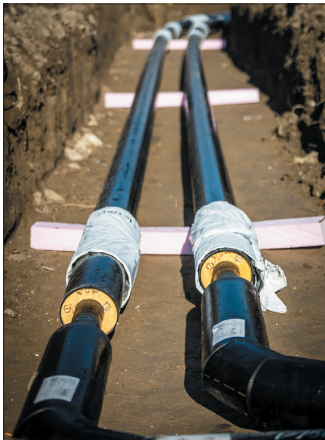
▲ Obr. 2 ● Napojení ocelového potrubí s alarm systémem
