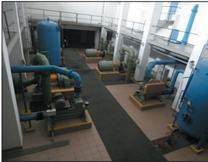
▲ Obr. 12 ● Strojovna s výtlačnými čerpadly
