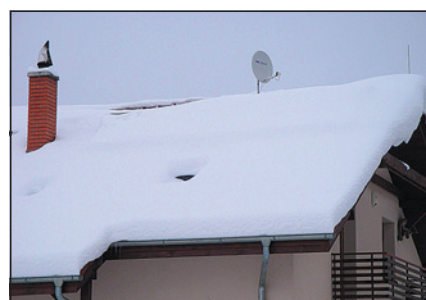
▲ Obr. 12 ● Působení sněhu na kolektory, popis v textu
