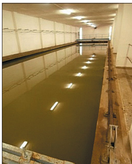
▲ Obr. 9 ● Sedimentační nádrž
