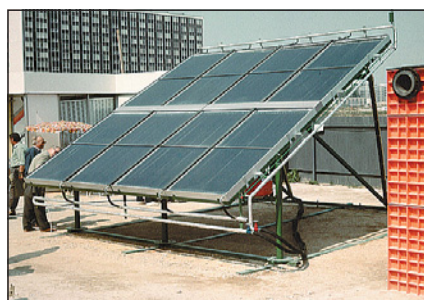
▲ Obr. 2 ● Napojovací místo pole je vpravo dole, Tichelmannova smyčka je na spodní straně kolektorů
