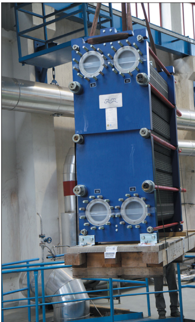
▼ Obr. 3 ● Instalace skládaného výměníku tepla Alfa Laval do provozu Červený mlýn, Teplárny Brno
