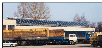
▼ Obr. 4 ● První řada kolektorů o velikosti 2 m 2 , za nimi druhá řada kolektorů o velikosti 2,75 m 2 , dva samostatné primární okruhy
