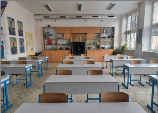
▲ Obr. 1 ● Přívod venkovního vzduchu do třídy
