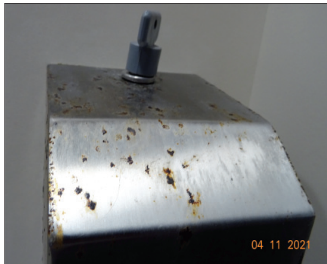
▲ Obr. 3 ● Korozní napadení nerezového příslušenství WC
