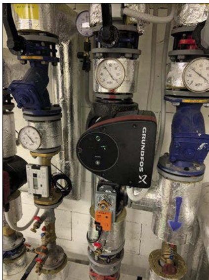
▲ Obr. 4 ● Statický vyvažovací ventil STAD na nesprávném místě okruhu vytápění (modrá šipka)
