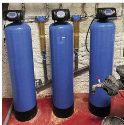
▼ Obr. 11 ● Katexové filtry pro změkčení tvrdé vody
