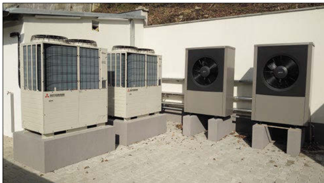
▲ Obr. 1 ● RZ MORAVA: Kombinace standardních a vysokoteplotních tepelných čerpadel pro přípravu teplé vody zásadně snižuje spotřebu elektřiny
