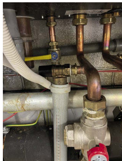
▲ Obr. 5 ● Pojistné ventily kotlů a odtok do kanalizace
