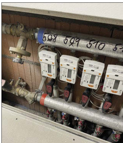
▲ Obr. 3 ● Rozdělovač se sběračem pro rozvod do bytů plastovým potrubím
