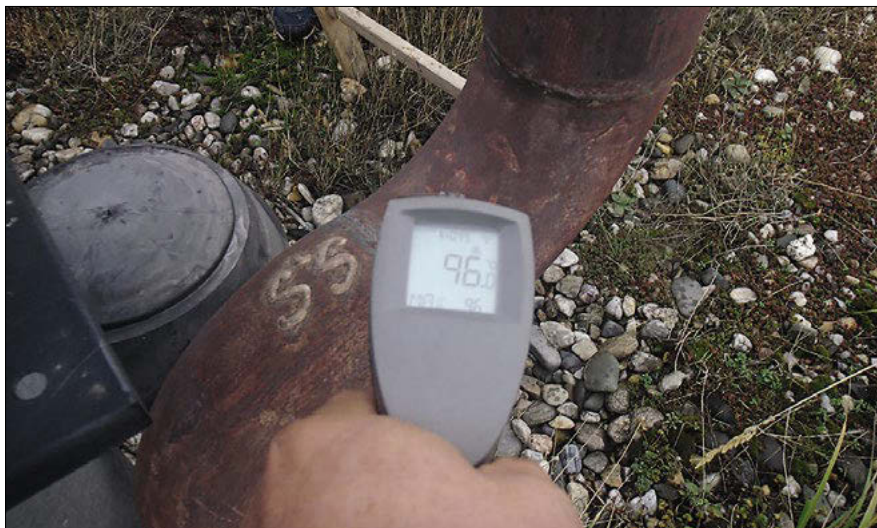
▲ Obr. 3 ● Povrchová teplota potrubí odvodu pojistného ventilu je 96 °C
