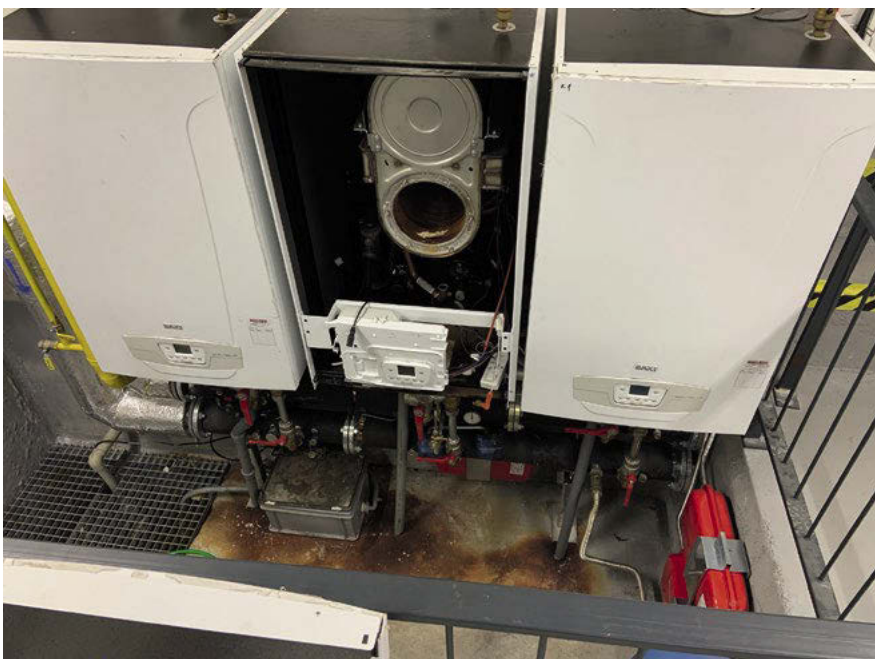
▲ Obr. 10 ● Poškozený spalínový výměník tepla
