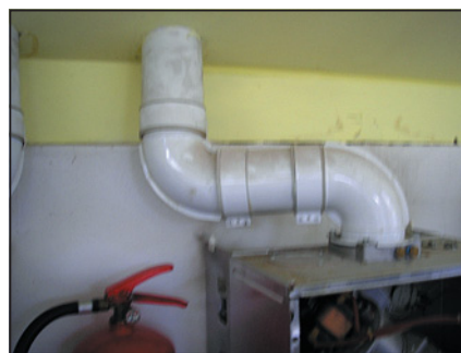
Obr. 2 Nenainstalovaný odvodňovací díl na vzduchospalinové cestě LAS zkracuje životnost kotle
