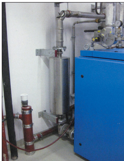
Obr. 4 Tlumič hluku AGG namontovaný ve spalínové cestě za malou kogenerační jednotkou
