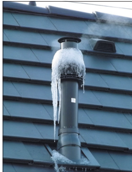
Obr. 1 Námraza na protidešťové stříšce ucpala přívod spalovacího vzduchu
