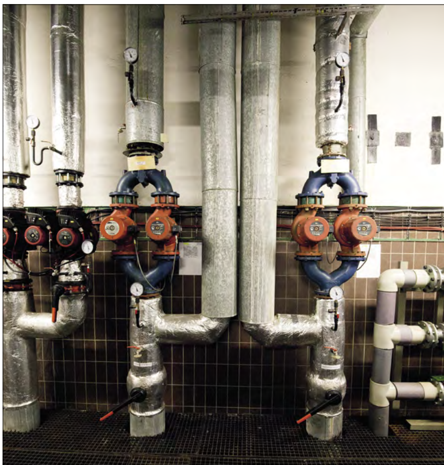
▼ Obr. 5 ● Čerpadlové skupiny kotlových okruhů (původní čerpadla firmy KSB již nahrazena čerpadly Grundfos)
