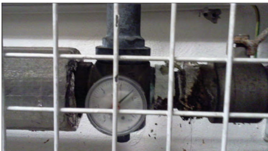
▼ Obr. 3 ● Redukční ventil osazený původně na přívodu studené vody do jednotlivé sekce domu
