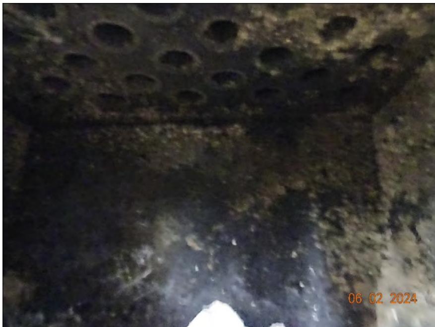
▲ Obr. 6 ● Vnitřní teplosměnné plochy krbové vložky nebyly poškozeny nadměrným přetlakem
