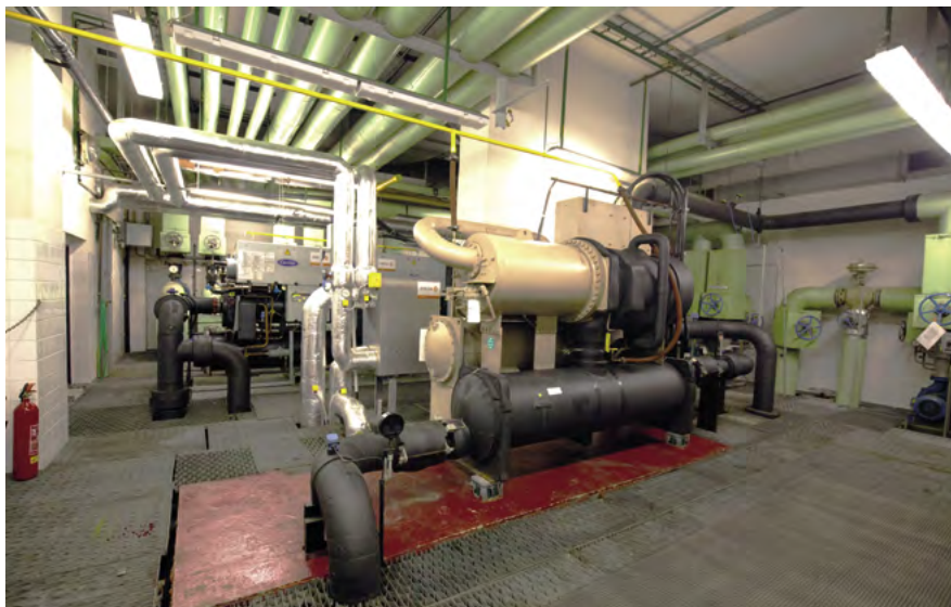
▲ Obr. 6 ● Chladicí jednotka Trane
