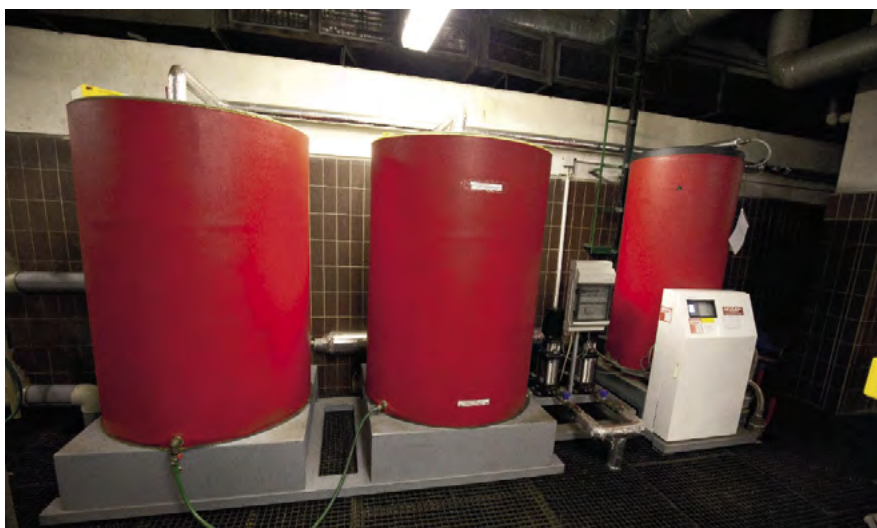
▲ Obr. 7 ● Expanzní zařízení Olymp nahradilo původní zastaralé expanzní zařízení
