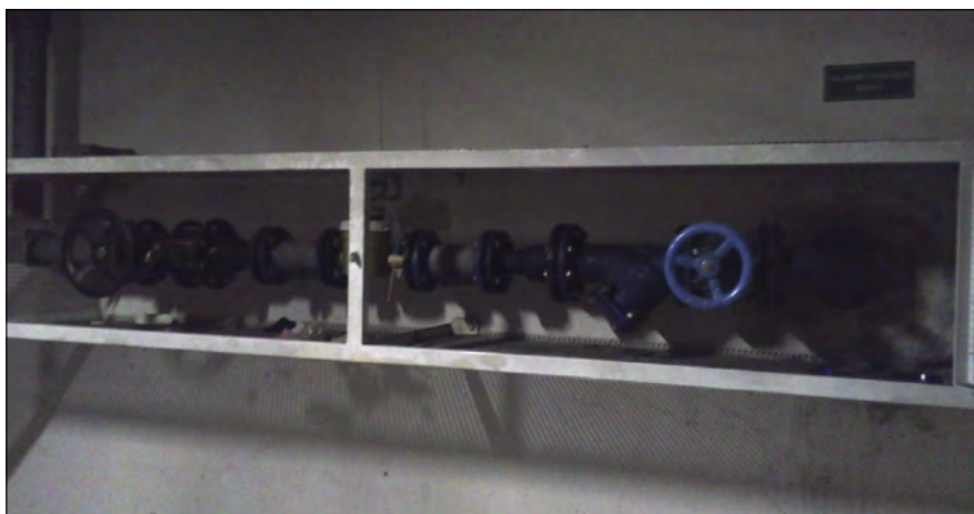
▲ Obr. 2 ● Vodoměrová sestava na vodovodní přípojce
