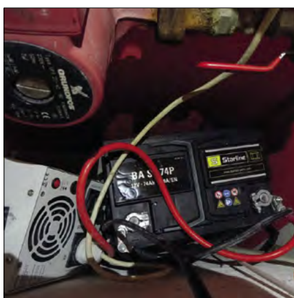
▲ Obr. 5 ● Oběhové čerpadlo, záložní akumulátor, záskokový střídač
