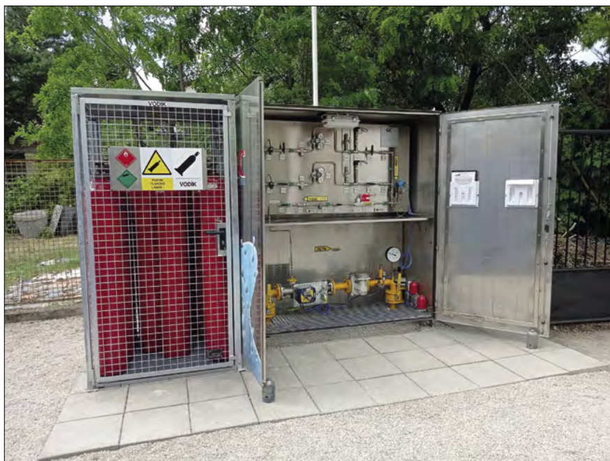
▲ Obr. 4 ● Směšovací stanice v Blatné na Ostrove (SK) – směs 10% vodíku se zemním plynem ve stávající plynárenské síti
