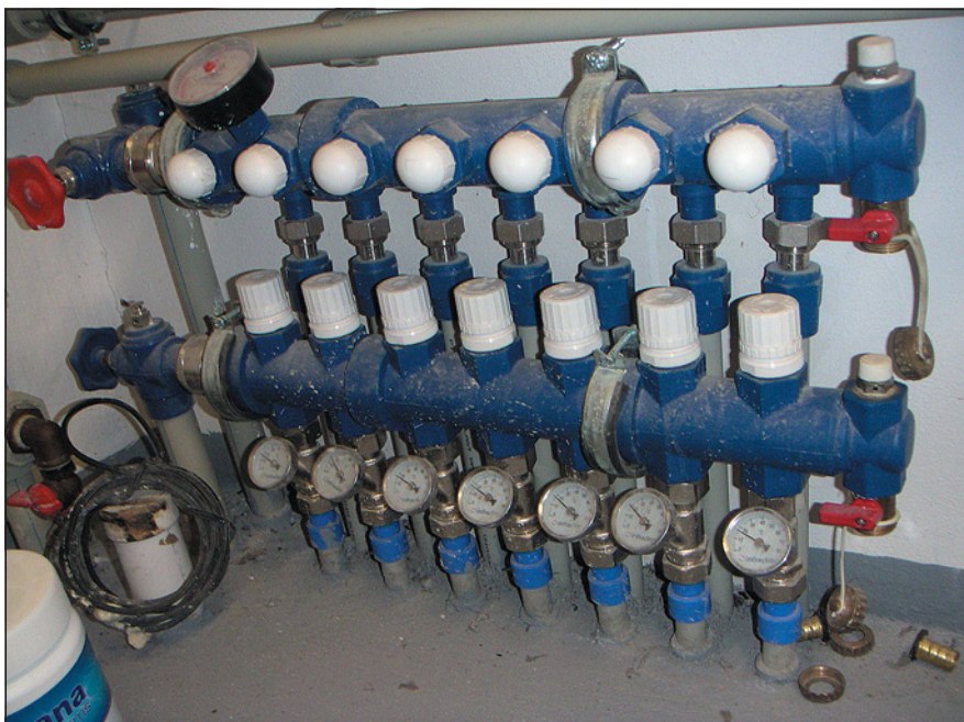
▲ Obr. 1 ● Potrubní okruhy nejsou označeny, nejsou opatřeny průtokoměry, rozdělovače nejsou opatřeny měřícími a regulačním armaturami – otopnou soustavu nelze vyvážit
