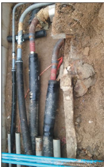
▲ Obr. 7 ● Izolace varných přechodů z ocelového potrubí na PB (polybutenové potrubí); odhalené části stávajícího potrubí byly zaizolovány po zprovoznění přípojky
