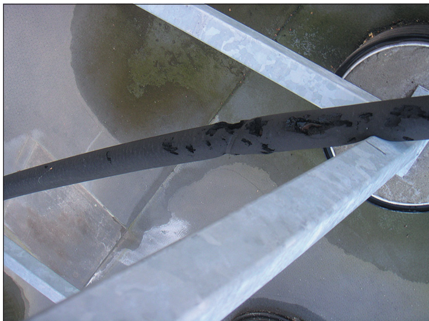
▲ Obr. 3 ● Na několika místech je viditelné poškození tepelných izolací plectvem
