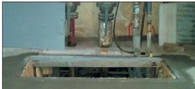
▲ Obr. 9 ● V podlaze byl ponechán kontrolní otvor s přístupem ke spojům potrubí, který bude zakryt poklopem
