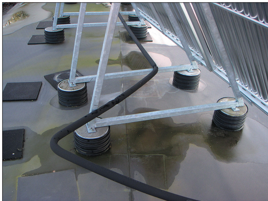
▼ Obr. 2 ● Solární kolektory nejsou zajištěny proti působení větru – došlo k posunutí nosné konstrukce
