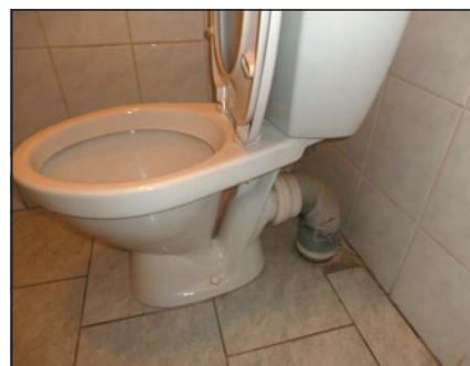
▲ Obr. 11a, b ● Připojení WC mísy na připojovací potrubí ve stěně (11a) a na připojovací potrubí v podlaze (11b). V obou vyobrazených případech je však třeba si položit otázku, zda použití hadice bylo skutečně nutné, zda nebylo jen důsledkem neochoty řemeslníka napojení řešit tvarovými kanalizačními prvky
