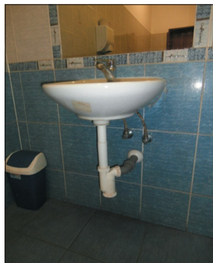
▲ Obr. 6 ● Příklad zcela neprofesionálního použití hadice k prodloužení svislé trubky pod umyvadlem k sifonu, které je důsledkem prvotní chyby nedodržení doporučeného umístění odvodu pod umyvadlem
