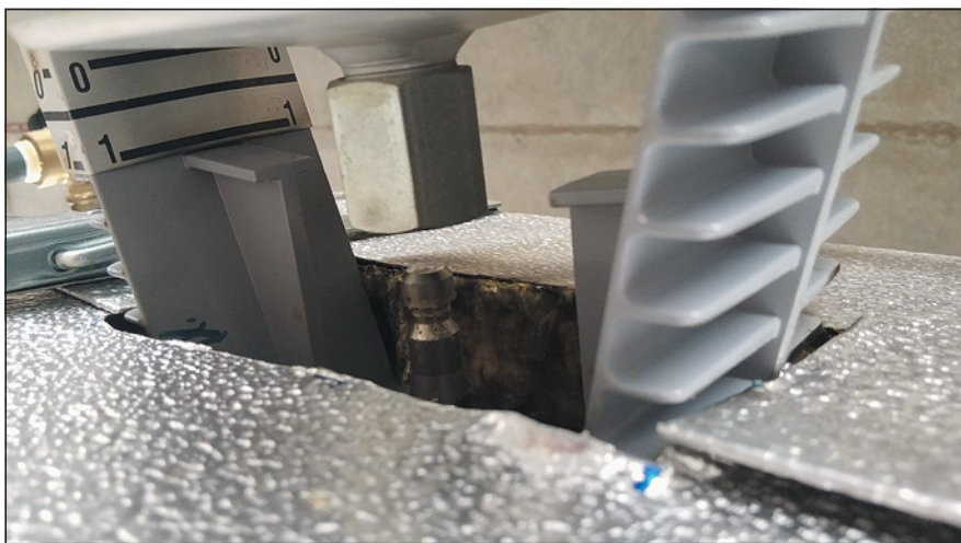
▲ Obr. 2 ● Odpojený pohon hlavního regulačního ventilu od táhla ventilu
