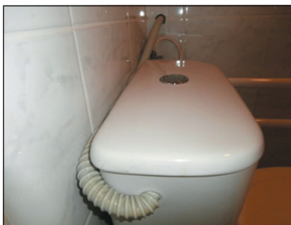
▲ Obr. 7a, b ● Připojení přeřadu pojistného ventilu z ohřivače vody
