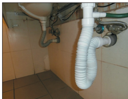
▼ Obr. 4 ● Připojení umyvadla flexi hadicí se dvěma hladkými konci – příliš velká výška vodního uzávěru – možnost usazování nečistot, které proud vody nedokáže odplavit
