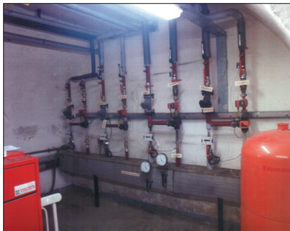
◀ Obr. 4 ● Pohled do kotelny s problémovým děleným rozdělovačem a sběračem otopné vody
