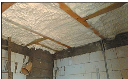
▼ Obr. 5 ● Tepelná izolace stavebních konstrukcí; nahoře izolační pěna, uprostřed polystyrenové desky, dole izolační vata
