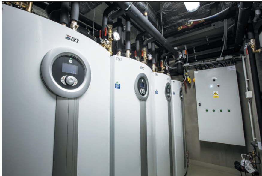
▼ Obr. 4 ● Kaskáda tepelných čerpadel IVT
