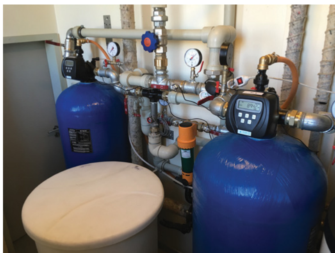
Obr. 1 Duplexní změkčovací zařízení pro hotelový komplex
