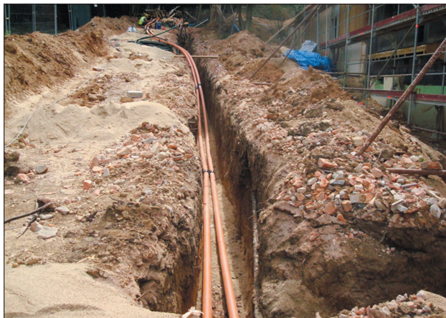
▲ Obr. 2 ● Potrubní napojení sběrné jímky vrtů se strojovnou TČ (materiál RC Protect)
