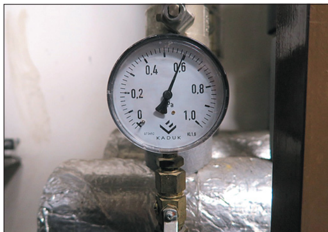
▲ Obr. 9 ● Tlak teplé vody
