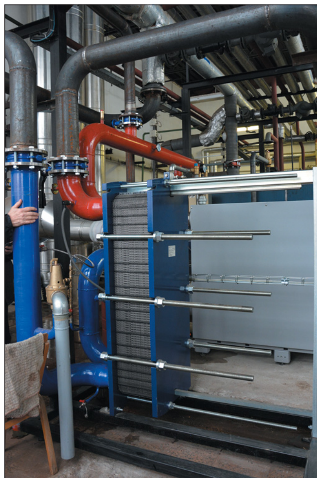
▼ Obr. 1 ● Výměníky tepla k oddělení kotlového okruhu
