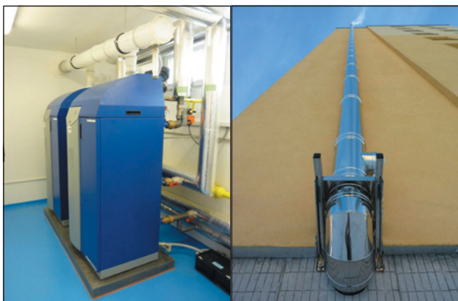
▲ Obr 7 ● Kotelna 2 × 80 kW, fasádní komín
