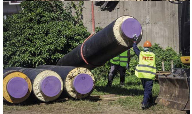
▲ Obr. 7 ● Ocelová předizolovaná potrubí v dimenzi DN500 [JAGA, Miro Pochyba]
