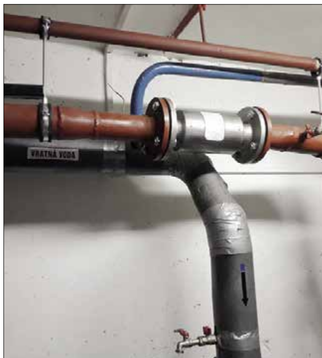
▲ Obr. 1 ● Zařízení AQT (přírubový spoj) namontované do soustavy vytápění s potrubními rozvody DN 65
