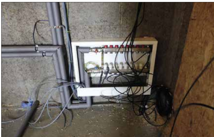
▲ Obr. 11 ● Rozvaděč tepla připravený pro připojení osmi topných okruhů (zdroj: autor)
