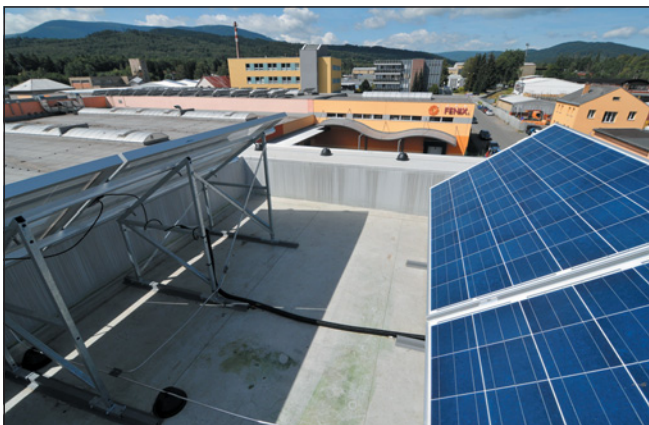
▼ Obr. 2 ● Fotovoltaická elektrárna na střeše administrativní budovy Fenix Trading v Jeseníku
