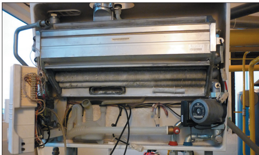
▼ Obr. 1 ● Výměník kotle po několika letech provozu
