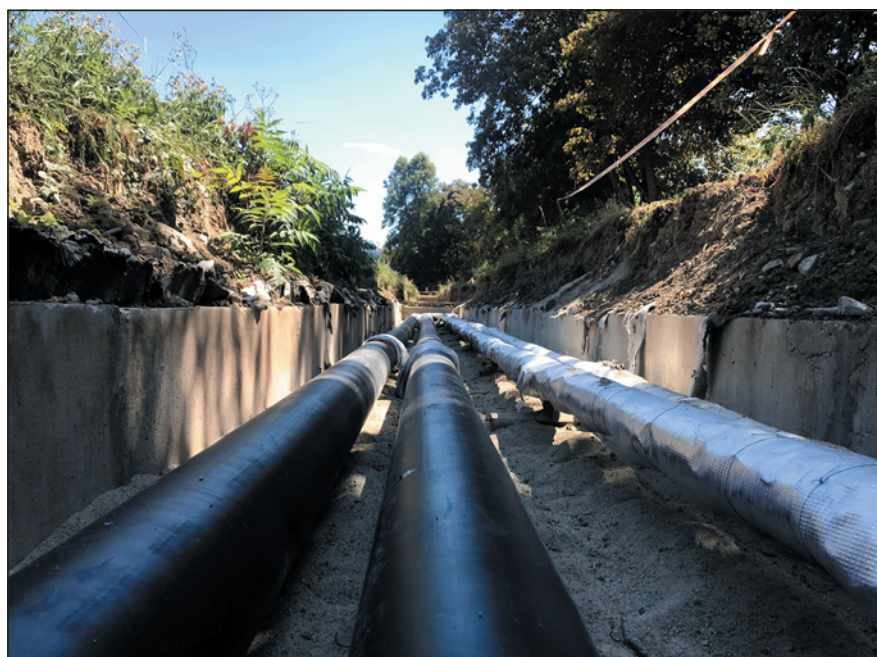
▼ Obr. 2 ● Ukázka teplovodního kanálu – dosluhující potrubí TV a cirkulace a nové ocelové předizolované potrubí na hlavní trase
