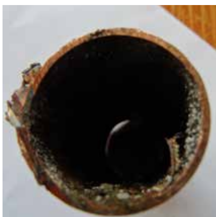
▲ Obr. 5 ● Usazeniny na vnitřním povrch trubky
