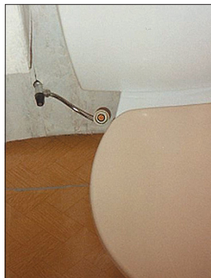
▲ Obr. 19 ● Poškozené těsnění
