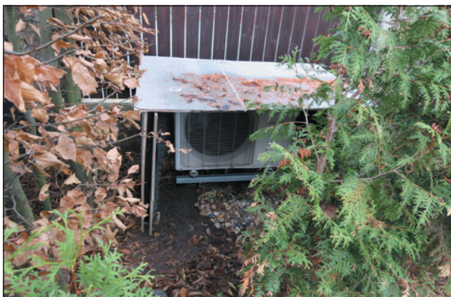
◀ Obr. 1 ● Venkovní jednotka TČ
