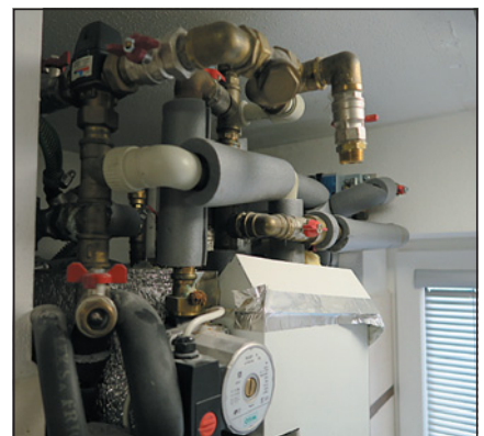
▲ Obr. 4 ● Chaotické uspořádání propojovacího potrubí TČ s krbovou vložkou
