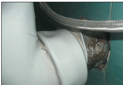
▲ Obr. 20 ● Prohnutá a v některých místech netěsnící manžeta
