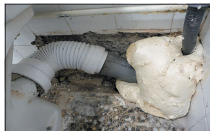
▲ Obr. 25 ● Ukázka špatného utěsnění spojů potrubí při připojení záchodové mísy
