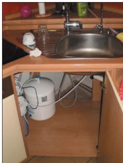
◀ Obr. 7 ● Domovní úpravna vody
