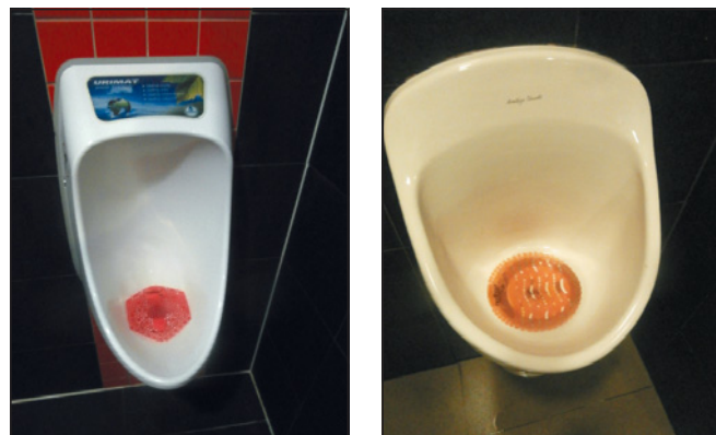
▲ Obr. 5 ● Bezvodé (nesplachované) pisoáry
