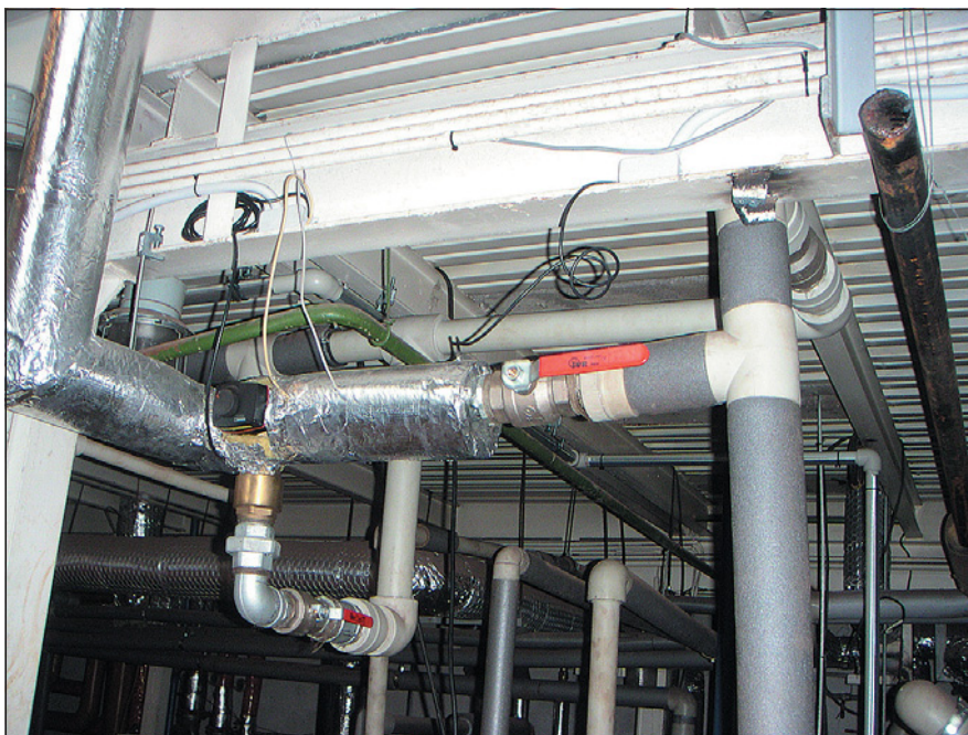
Obr. 3 Okruh cirkulace prochází všemi akumulacími nádobami v suterénu. Třícestný směšovací ventil se servopohonem, na obrázku v popředí, omezuje výstupní teplotu teplé vody ze solární soustavy na 50 °C
