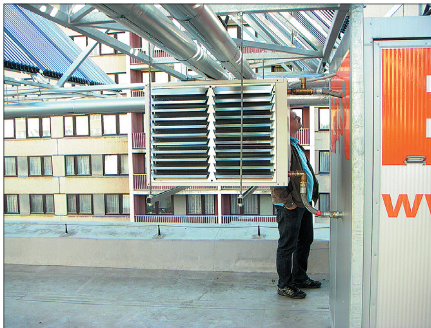
Obr. 4 Vzduchový chladič, který má řešit stagnační stavy
