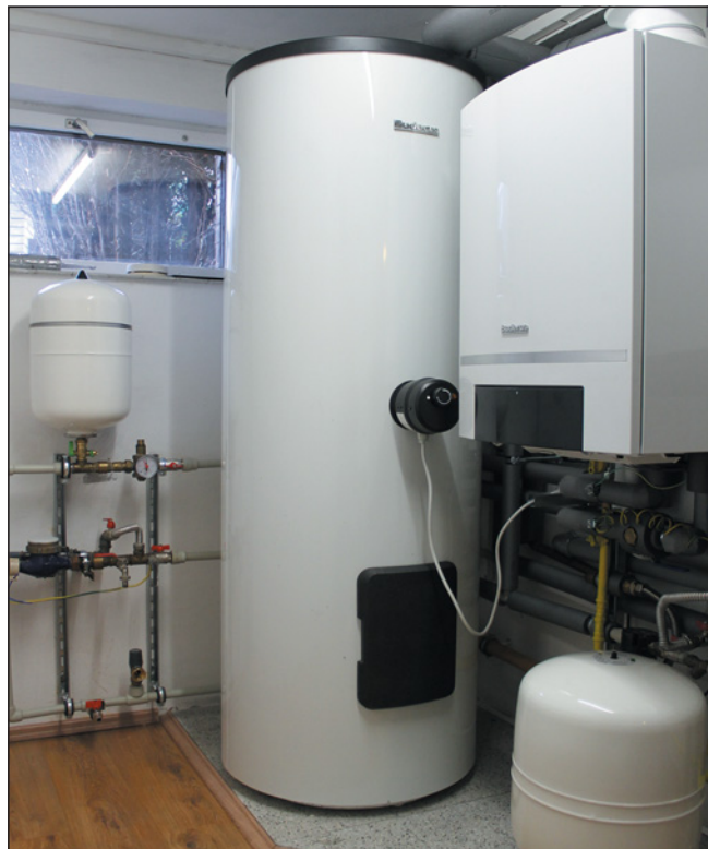
Obr. 3 Kotelna rodinného domu
