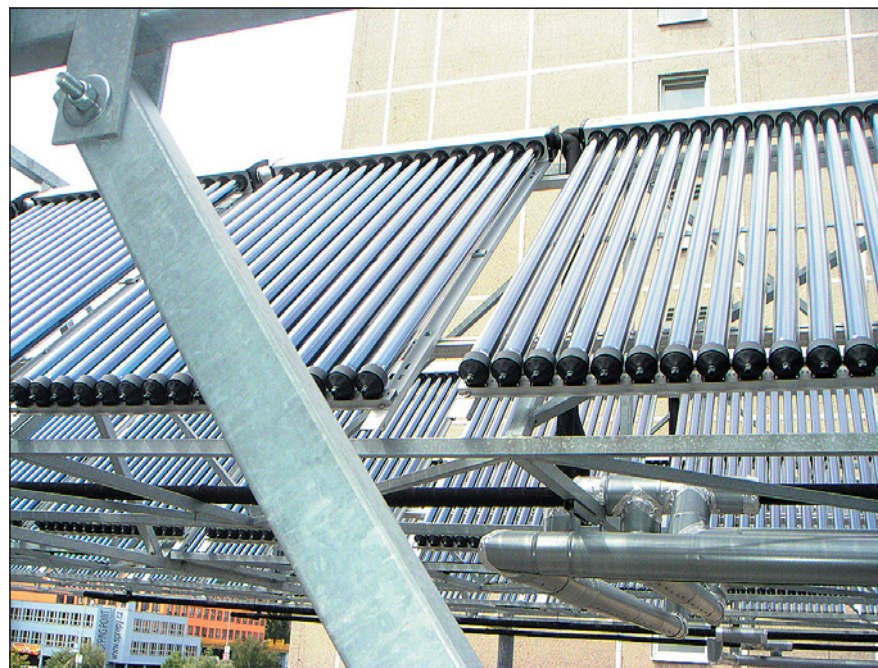
Obr. 1 Kolektorová pole jsou složena z 15 trubicových kolektorů
