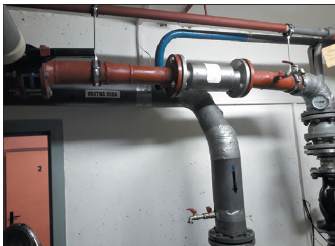
▲ Obr. 1 ● Zařízení AQT (s přírubami) namontované do otopné soustavy s potrubními rozvody DN 65 na místo vyříznuté části potrubí v délce 320 mm
