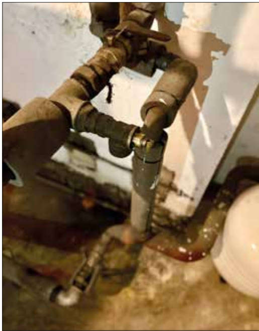
▲ Obr. 7 ● Staré ocelové potrubí s pojistným ventilem, ze kterého uniká nemrznoucí směs
