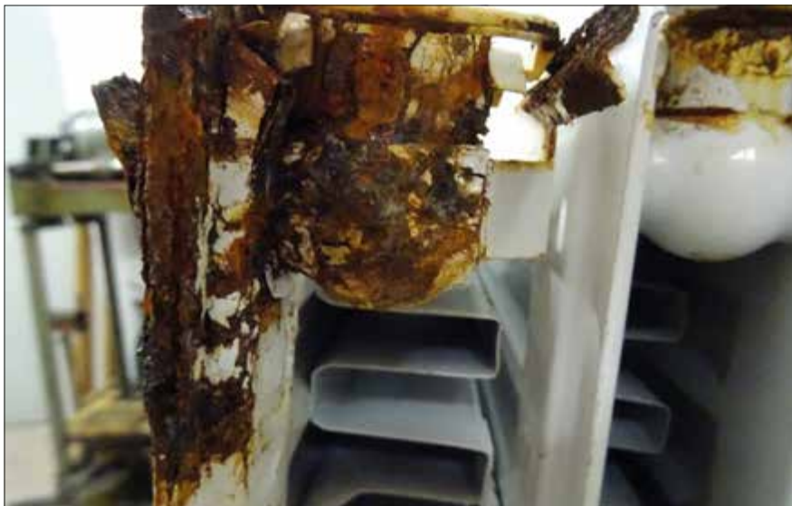
▲ Obr. 2 ● Netěsnosti způsobené korozi se nejčastěji vyskytují v dolních částech otopných těles, kde se usazují korozní produkty
