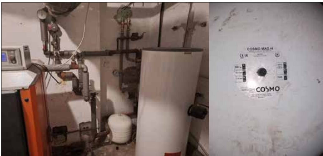
▲ Obr. 4 ● Staré rozvody v kotelně a 50litrová tlaková expanzní nádoba
