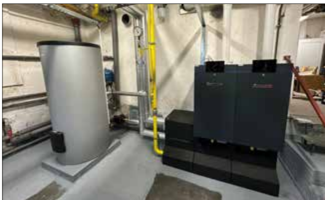
▲ Obr. 3 ● Plynová kotelna v ZŠ Bohuňovice
