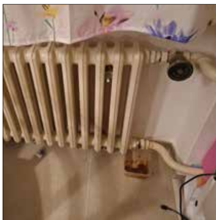
▼ Obr. 1 ● Netěsnící šroubení otopných těles
