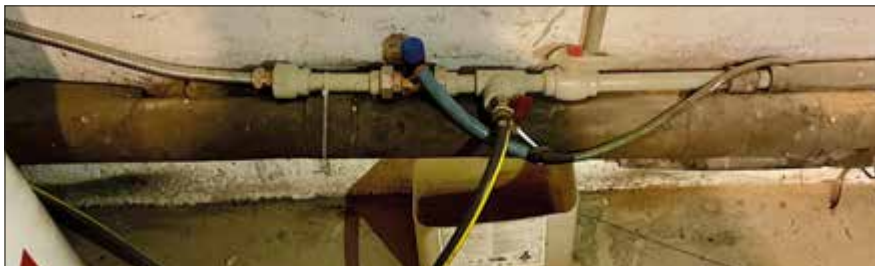
▲ Obr. 10 ● Přívod studené vody do bojleru
