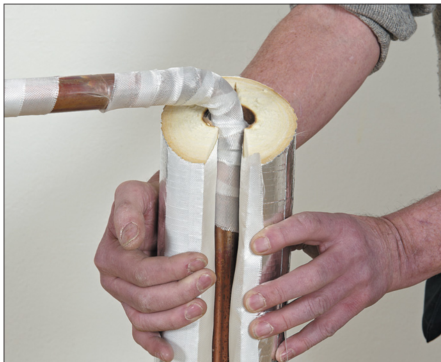
▼ Obr. 5 ● Izolace s kapilárně vodivou tkaninou na rozvodech studené vody (Zdroj: www.isover.cz)
