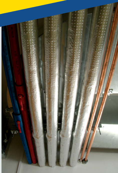
Chladicí rozvody v laboratoři TZB na VUT v Brně
