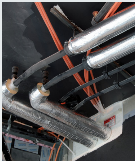
Rozvody chladu v CHÚC v OC Chodov
