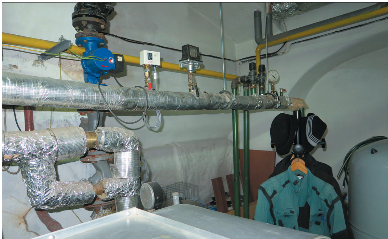
▼ Obr. 1 ● Dva pojistné ventily na expanzním potrubí
