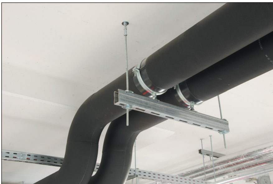
▲ Obr. 4 ● Potrubí izolované kaučukem bez ochrany oplechováním (Zdroj: Vít Koverdynský)
