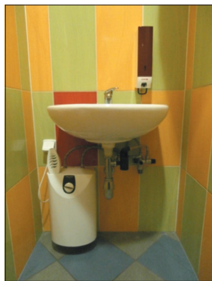
▲ Obr. 11 ● Elektrický zásobníkový ohřivač vody umístěný pod zařizovacím předmětem
