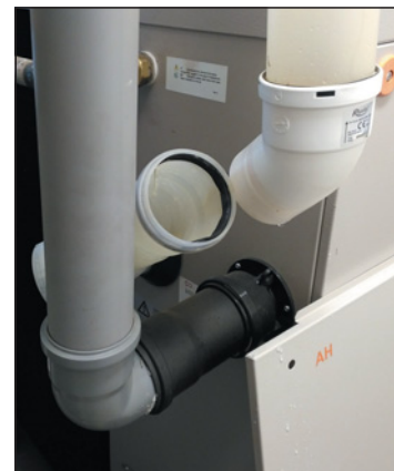
▼ Obr. 4 ● Kouřovod napojený pod úhlem 45°
