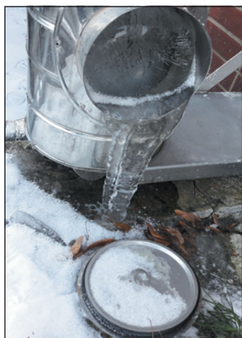
▼ Obr. 1 ● Zamrzlý kondenzát v kontrolním otvoru v patě komínu
