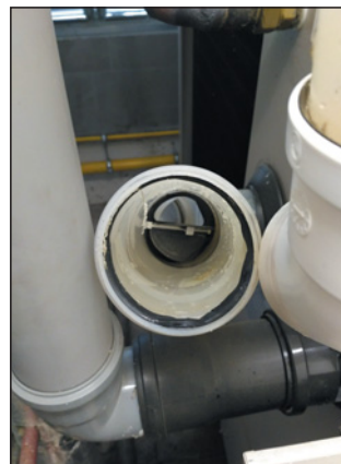
▼ Obr. 3 ● Pohled na nevhodně instalovanou zpětnou klapku
