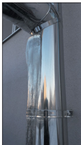
▼ Obr. 2 ● Průnik kondenzátu na plášť komínu vlivem deformace
