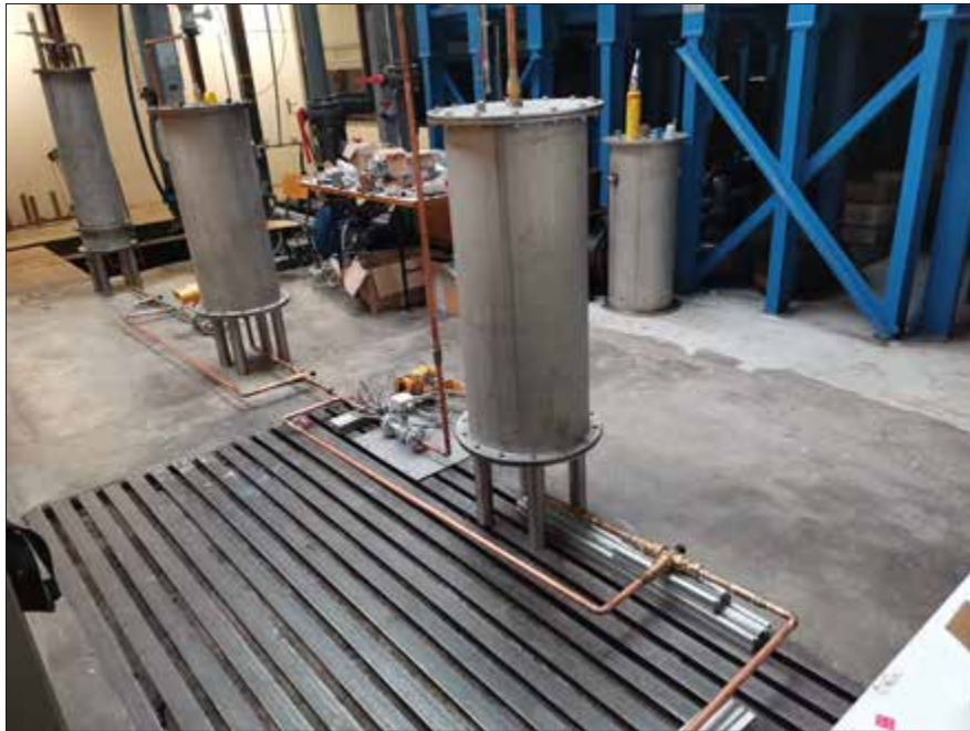
▲ Obr. 1 ● Montáž tří spolupracujících akumulčních nádob s různými PMC látkami
