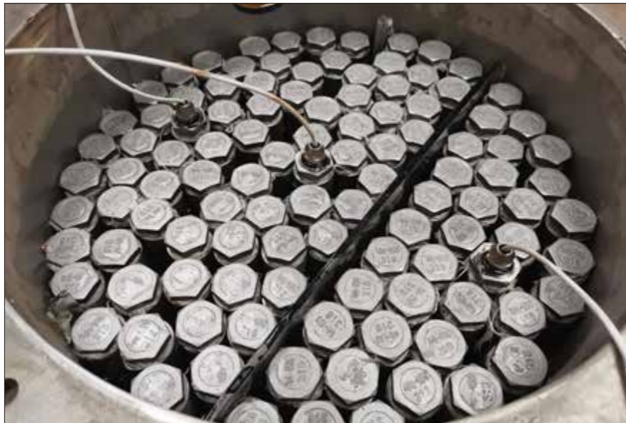
▼ Obr. 3 ● Vnitřek jedné z nádob akumulátoru tepla s vloženými kontejnery s PCM látkou
