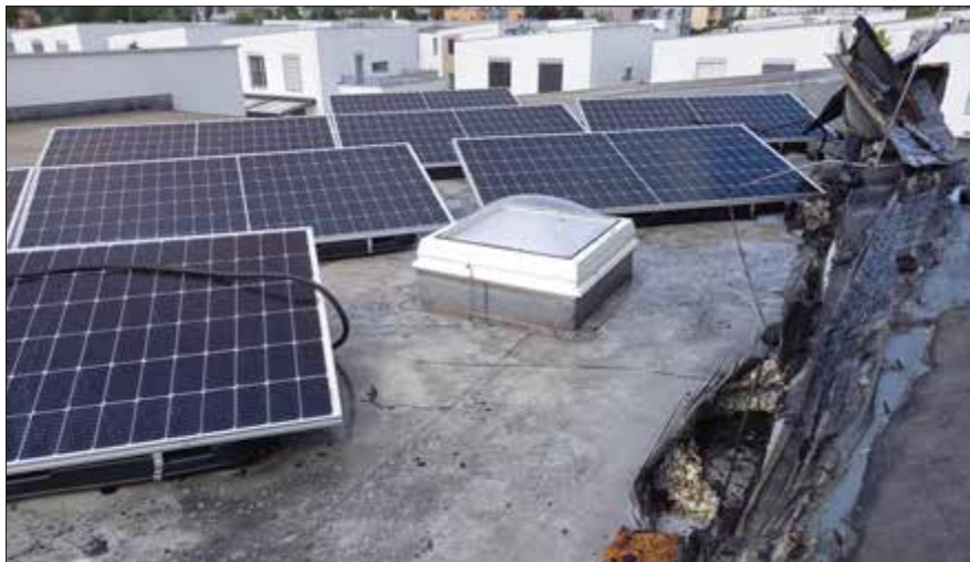
▼ Obr. 1 ● Následky požáru fotovoltaické elektrárny (zdroj: Hasičský záchranný sbor hl. m. Prahy)
