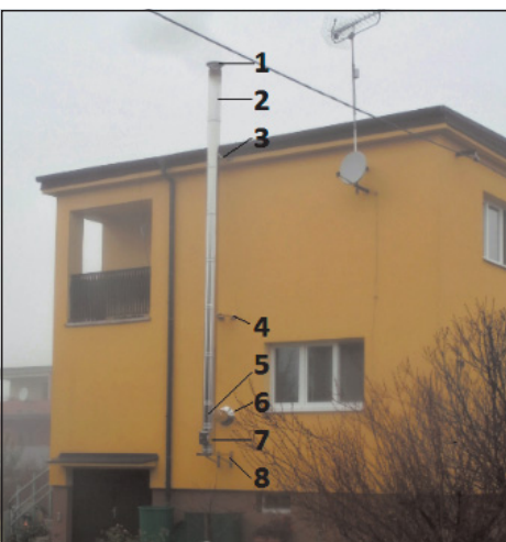
◀ Obr. 9 ● Nerezový komín 1 – protidešťová hlava, 2 – nejvyšší komínový díl, 3 – horní upevnění, 4 – spodní upevnění, 5 – napojení kouřovodu, 6 – omítkový kroužek, 7 – čistící díl, 8 – nosná konzole
