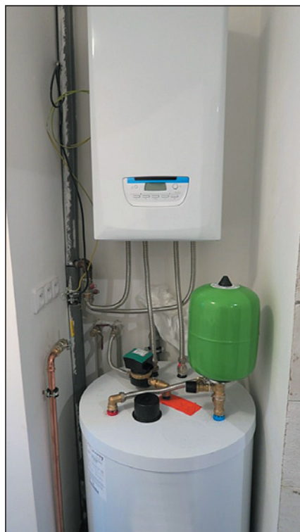
▲ Obr. 8 ● Plynový kotel s kombinovaným ohříváčem vody
