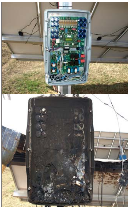
▲ Obr. 6 ● Neodborná montáž FV panelů a používání nesprávných komponentů a kabelů v celém systému zvyšuje nebezpečí požáru
