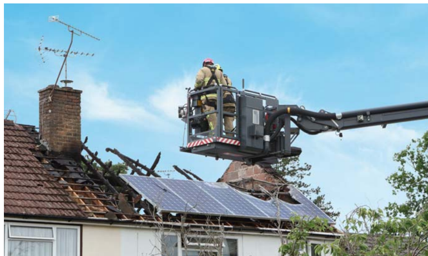
▼ Obr. 3 ● Zásah hasičů v obci Warlingham při požáru střechy s FVE
