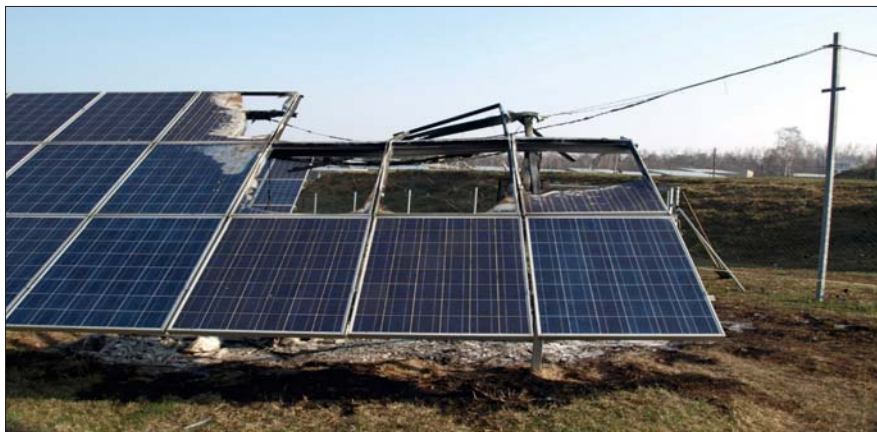
▲ Obr. 4 ● Následek poruchy přepětových ochran
