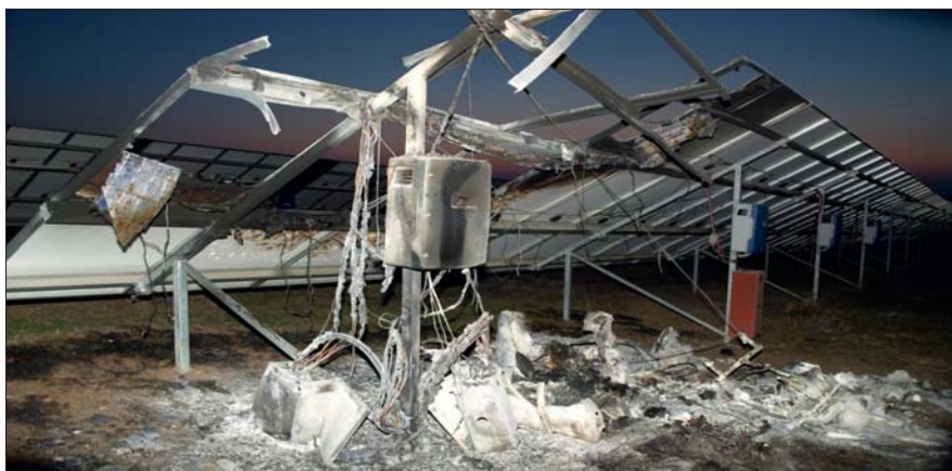
▲ Obr. 5 ● Následek poruchy přepětových ochran
