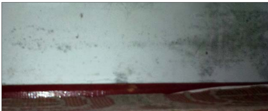
▲ Obr. 6 ● Plíseň na zdi pod oknem, kde není umístěn radiátor
