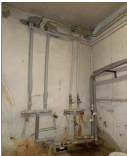
▲ Obr. 4 ● Potrubí za výměňkovou stanicí bez řádného upevnění
