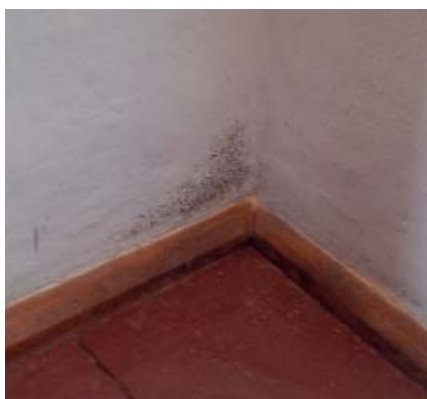
▲ Obr. 2 ● Vlhkost v rohu místnosti, která je vně ochlazovaná
