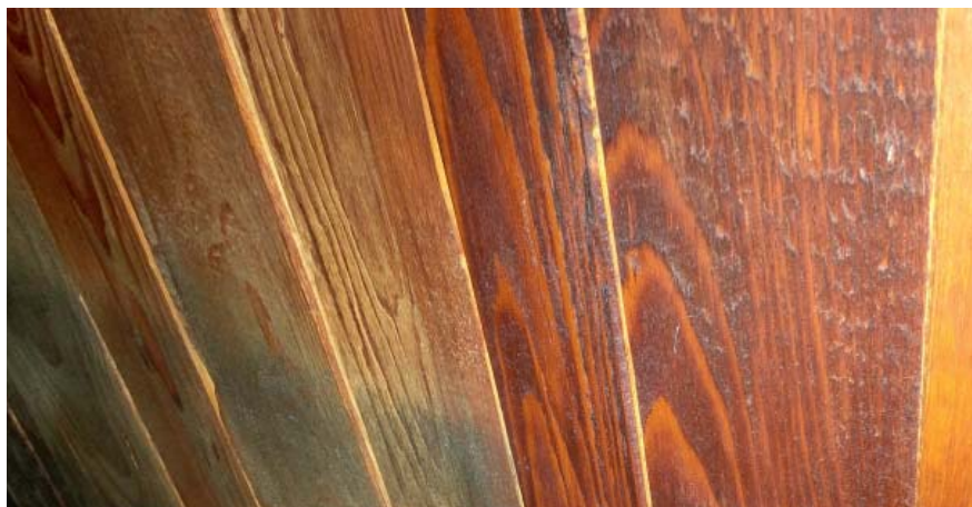
▲ Obr. 4 ● Nedostatečné proudění u dřevěného obložení způsobené doražením nábytku ke stěně – viditelná hranice výskytu plísní změnou barvy dřevěného obložení
