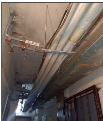
▲ Obr. 1 ● Jednotlivé dilatační úseky potrubí nejsou zajištěny objímkami
