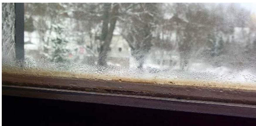
▼ Obr. 5 ● Chladný povrch okna způsobený nevhodným umístěním radiátoru
