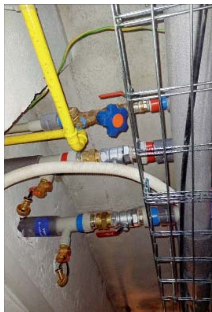
▼ Obr. 17*) ● Pět let staré regulační armatury z původního rozvodu
