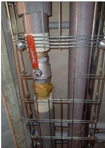
▲ Obr. 14 ● Bezproblémový přístup k uzavíracím a vypouštěcím armaturám
