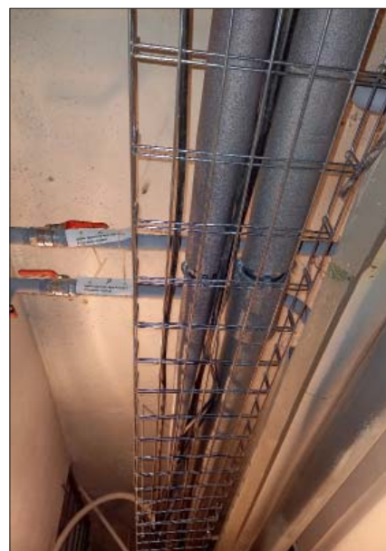
▲ Obr. 13 ● Ležaté rozvody umístěné v drátěných žlabech
