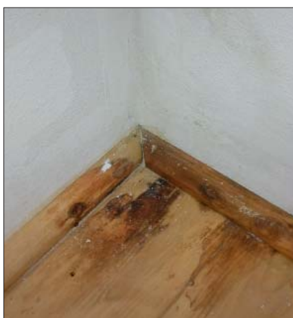
▲ Obr. 3 ● Kondenzace spolu s pronikáním vlhkosti nefunkční hydroizolací podlahy
