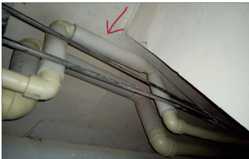
▼ Obr. 3 ● Kompenzátor nemá dostatečnou kompenzační délku
