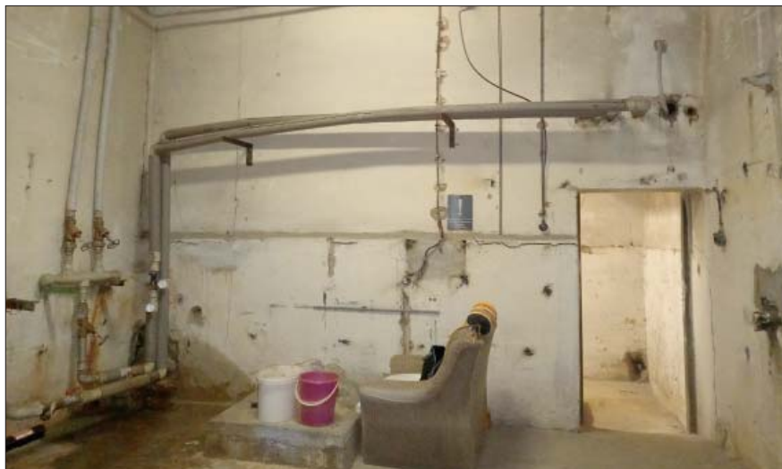
▲ Obr. 5 ● Potrubí za výměňkovou stanicí bez řádného upevnění
