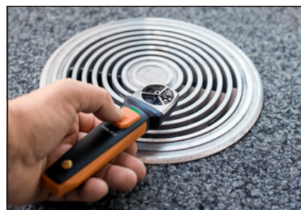
Měření rychlosti proudění vzduchu na výstupu s přístrojem testo 410i
