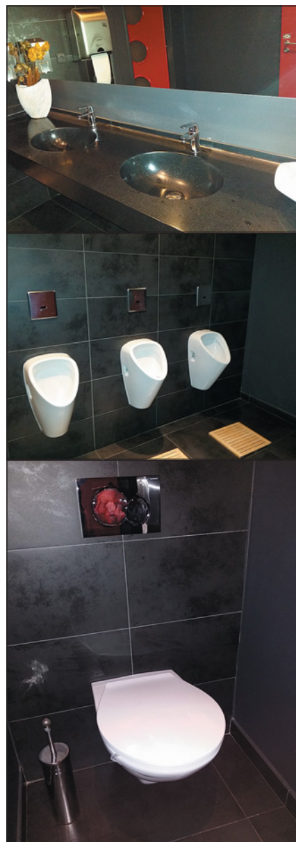
▼ Obr. 20 ● ZP na lodi Grosetto – umyvadla, pisoáry, WC mísa
