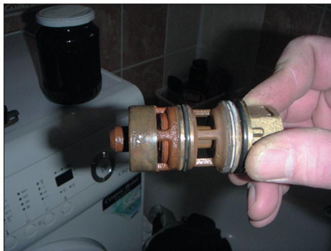
▲ Obr. 2 ● Produkty a pouzdra mikroorganizmů tvoří zprvu měkký, ale později až velmi pevný povlak vnitřních částí soustavy, který způsobuje poruchy pohyblivých i nepohyblivých částí
