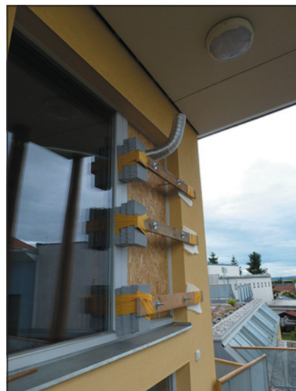
▲ Obr. 2 ● Provizorní řešení odvětrání odpadních potrubí oknem pro ověření příčiny závady
