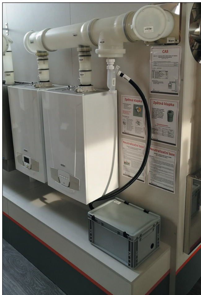
▲ Obr. 2 ● Ukázka zapojení neutralizačního boxu Almeva – napojení pomocí hadice určené k odvodu kondenzátu ze sifonu k předem přichytnému otvoru v neutralizačním boxu
