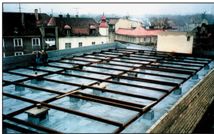
▼ Obr. 7 ● Nosná konstrukce jednořadá kotvená do bloků na střeše
