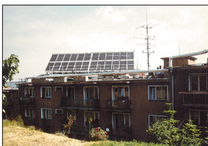
▲ Obr. 6 ● Velké kolektorové pole na ploché střeše se mělo sklánět 45/30°, ale nikdy k tomu nedošlo
