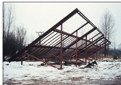
▼ Obr. 12 ● Další speciální solární stavba, pod kterou je úprava a ohřev vody pro venkovní bazén, kolektory již tvořily střechu v rovině
