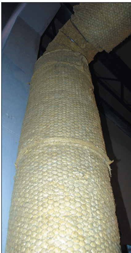
▲ Obr. 4 ● Kouřovod izolovaný rohožemi na pleťivu
