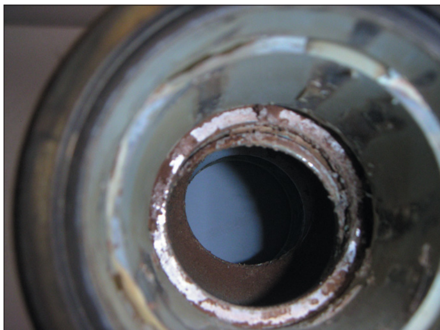
▼ Obr. 1 ● Vnitřní část kulového ventilu, inkrusty zamezí pohybu vnitřní části
