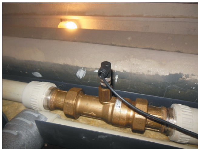
▼ Obr. 1 ● Průtokoměr osazený v potrubí
