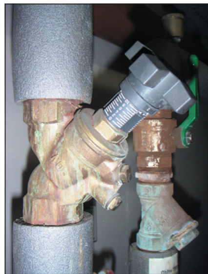
▲ Obr. 1 ● Otopnou soustavu napájela upravená voda ze systému CZT, rozvodné potrubí i otopná tělesa byla ocelová, přípojné potrubí k tělesům z plastových trubek, vyskytovaly se opakované netěsnosti otopné soustavy
