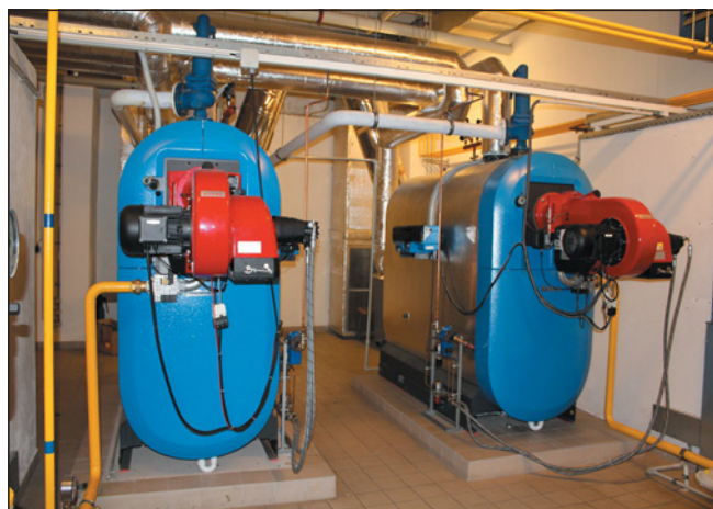
▲ Obr. 4 ● Kaskáda stacionárních kondenzačních kotlů Logano plus SB745
