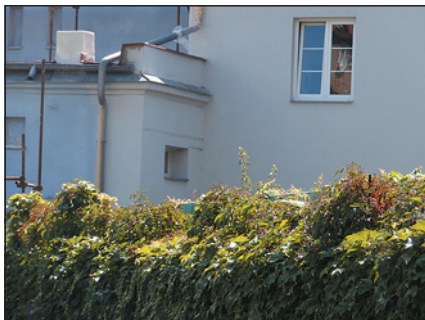
Obr. 10 Chybějící uchycení potrubí
