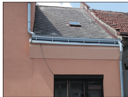
Obr. 6 Voda ze dvou střech svedená do jednoho žlabu
