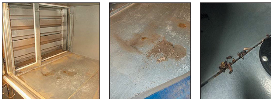
Obr. 1 Ukázka znečištění filtrační komory na straně nasávaného čerstvého vzduchu (vlevo), vpravo zachycené pevné látky ve spáře mezi panely (porucha celistvé hladkosti vnitřního povrchu jednotky)
