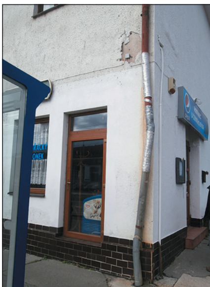
Obr. 17 Nevhodný materiál potrubí
