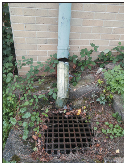
Obr. 24 Chybné napojení dešťového odpadu
