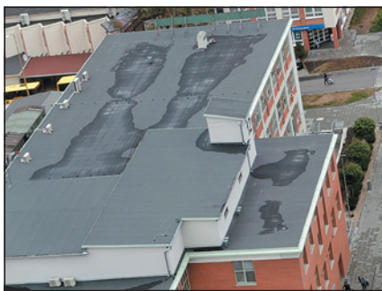
Obr. 4 Špatný spád střechy
