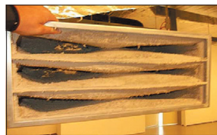
Obr. 2 Ukázka znečištění filtrační komory a filtru na straně odváděného vzduchu z prostoru operačního sálu a jeho zázemí
