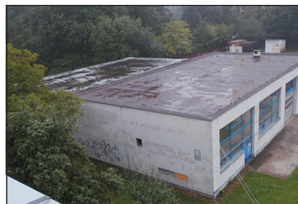
Obr. 3 Ucpaný střešní vtok
