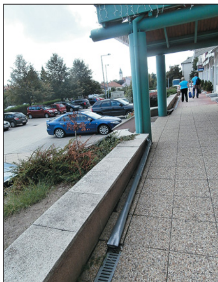
Obr. 30 Ležaté potrubí volně položené na chodníku
