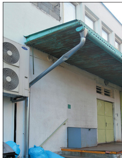
Obr. 21 Nevhodně vedené potrubí
