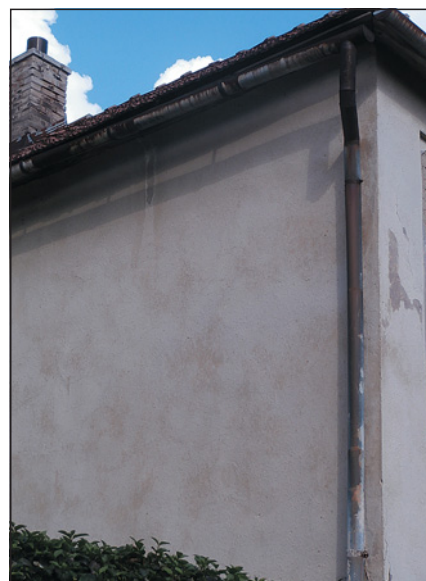
Obr. 7 Rezavé ležaté potrubí
