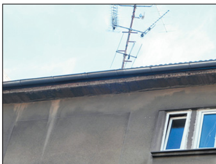
Obr. 1 Opadaná omítka pod žlabem
