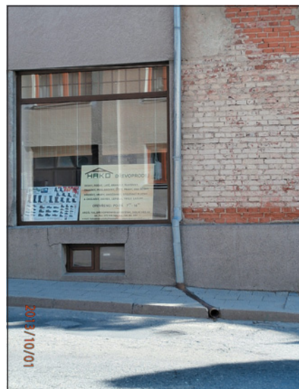
Obr. 31 Voda volně vytékající na vozovku
