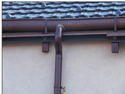
Obr. 12 Malý průměr svislého potrubí
