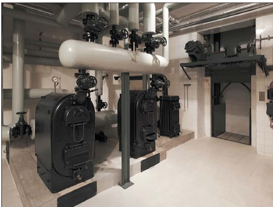
Kotelna ve vile Tugendhat – v popředí dva litinové kotle Original Strebela, za nimi menší litinový kotlík Camino Strebela, na kterém je patrné, že vznikl z lokálních násypných kamen, palivo – koks
