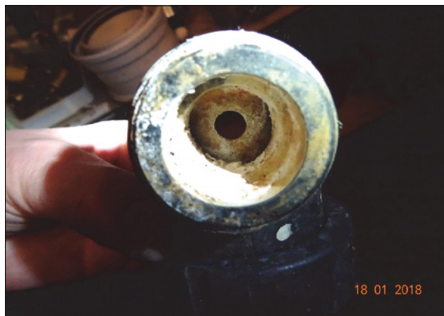
▲ Obr. 2 ● Nevhodným způsobem aplikace chemických prostředků byly zničeny regulační a uzavírací armatury
