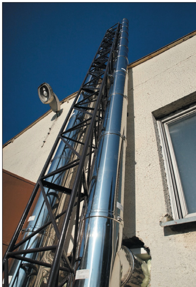
▲ Obr. 3 ● Dva komíny vedené po fasádě v systému DW25 kotvené na konstrukci
