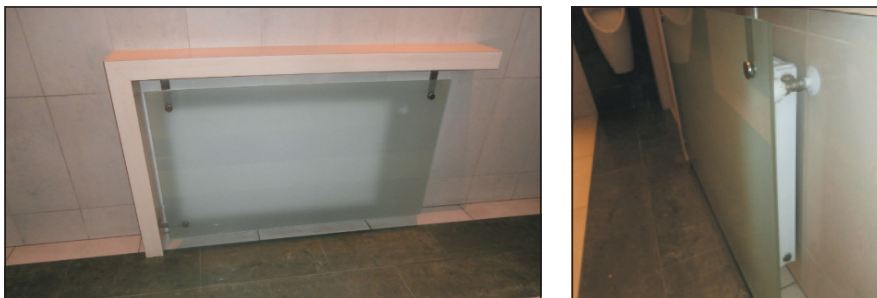
▲ Obr. 26 ● Možné překážky při cirkulaci vzduchu
