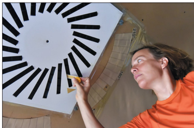
▲ Obr. 2 ● Vzduchotechnika je dnes nedílnou součástí staveb, říká Rubinová, foto: Igor Šefr
