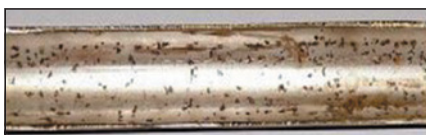
Obr. 1 Bodová koroze potrubí z nerezavějící oceli (obrázek z diskuzního fóra www.svarforum.cz )
