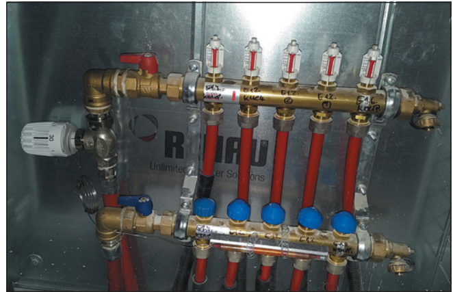
▲ Obr. 7 ● Vložení termostatického ventilu do přívodu otopné vody
