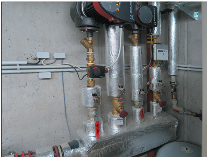
▲ Obr. 1 ● Směšovací stanice v kotelně
