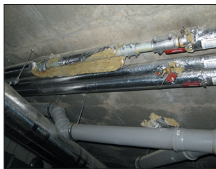
▲ Obr. 1 ● Stav pozinkovaného potrubí před výměnou
