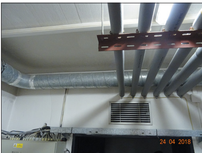
▼ Obr. 1 ● Přívod větracího vzduchu je pod stropem
