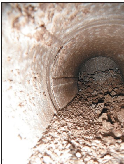
▲ Obr. 2 ● Kondenzátní jímka je nekontrolovatelná, je zcela zaplněná pevnými úsadami, které vyplňují i velkou část souchu
