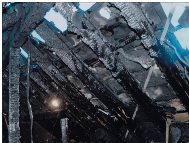
▼ Obr. 2 ● Pohled na požárem nejvíce poškozenou hřebenovou část dřevěné konstrukce střechy v oblasti kolektorů a část střechy vedoucí podél nich
