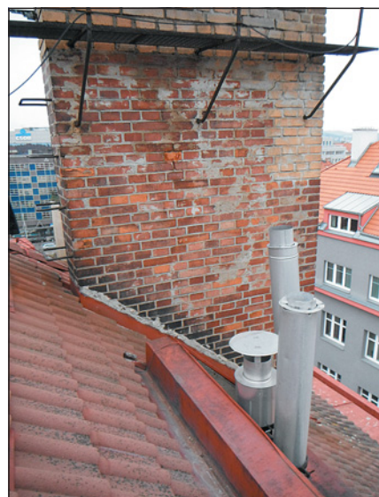
▼ Obr. 3 ● Komínové těleso vytvořené azbestocementovou trubkou, vedenou ve světlíku s hliníkovou komínovou vložkou, je vyvedené nízko pod hřebenem střechy a ještě jeho ústí je zastíněné vedlejším zděným komínovým tělesem
