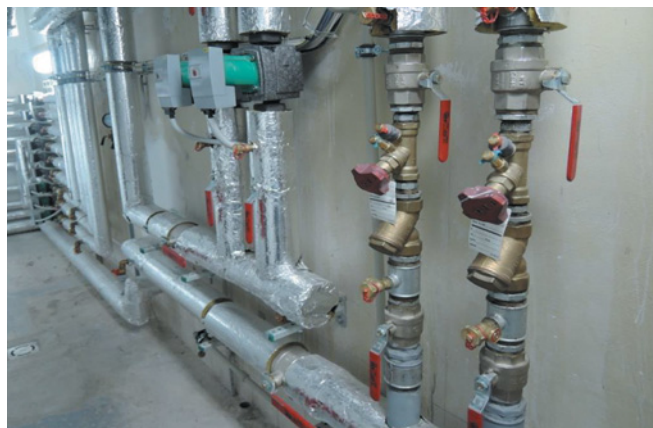
▲ Obr. 9 ● Rozvody, rozdělovač
