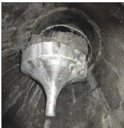
▼ Obr. 7 ● Spalinová cesta pro kotel ÚT na plynná paliva – kategorie „B“. Kondenzátní jímka ucpaná usazeninami a nečistotami vzniklými působením kondenzátu
