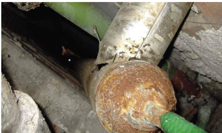
▲ Obr. 6 ● Spalinová cesta pro průtokový ohřivač na plynná paliva – kategorie „B“. Vlivem působení kondenzátu došlo k úplné korozi komínových vložek s jejich následnou destrukcí
