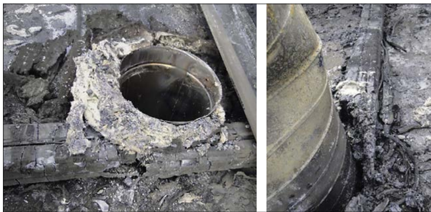
▲ Obr. 4 a, b ● Spalínová cesta pro technologický spotřebič na plynná paliva – následky požáru střešní konstrukce výrobní haly; požár vznikl od nesprávně namontované spalínové cesty v prostupu střešní konstrukcí
