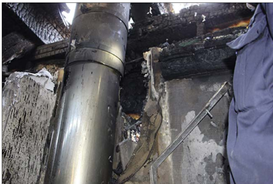
▲ Obr. 3 ● Spalínová cesta pro křbovou vložku na plynná paliva – střešní konstrukce po požáru způsobeném nesprávně namontovanou spalínovou cestou v prostupu střešní konstrukcí
