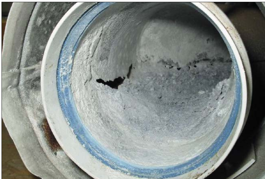
▲ Obr. 5 ● Spalinová cesta pro kotel ÚT na plynná paliva – kategorie „C“. Uvnitř soustředného vzducho-spalinového systému je viditelné velké množství pevných usazenin, které vznikly působením kondenzátu a netěsností, které vznikly prorezavěním vnitřní části spalinové cesty
