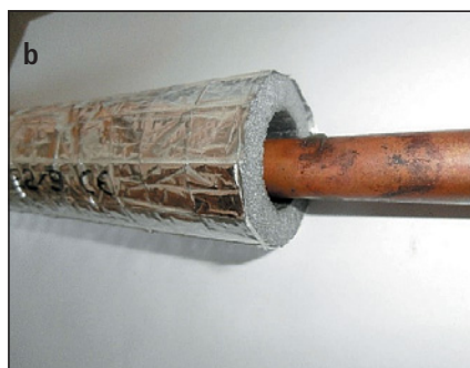
▲ Obr. 22 ● Špatný průměr izolace a) malý průměr izolace b) velký průměr izolace
