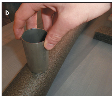
▲ Obr. 12 ● Řezání tepelněizolačních trubek a) v pokosníku pod úhlem 45° b) otvoru výkrúžníkem
