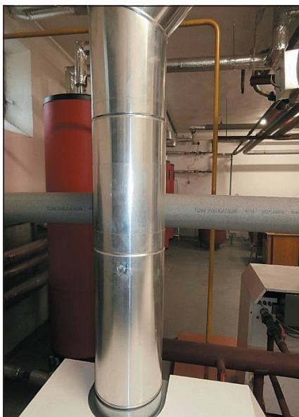
▲ Obr. 24 ● Potrubí z pěněného PE vedené v blízkosti kouřovodu se vlivem vysoké teploty poškodí
