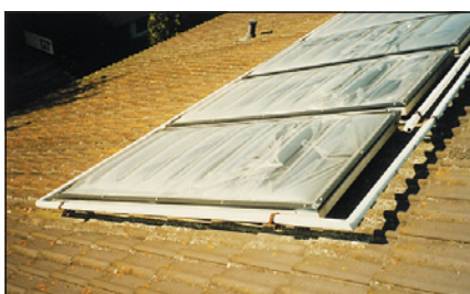
▼ Obr. 5 ● Kryt z plexiskla s prasklými fóliemi z PE
