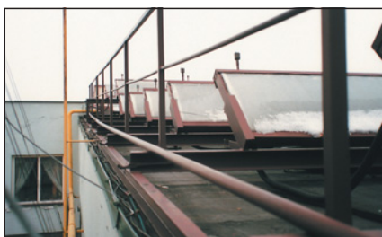
▲ Obr. 15 ● Zasklené radiátory, Stará Role u Karlových Varů, realizace 1981 až 1983: 40 kolektorů v jedné sérii!
