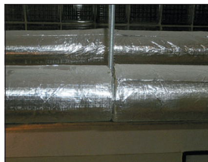
▲ Obr. 23 ● Chybí část izolace a) na části trubky a kolenu b) na části trubky v místě zavěšení
