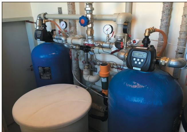
▲ Obr. 1 ● Duplexní změkčovací zařízení pro hotelový komplex
