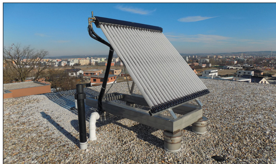
▼ Obr. 4 ● Trubicový kolektor F = 3,03 m 2 na střeše RD
