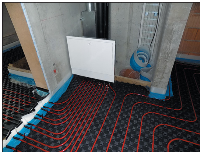
▲ Obr. 3 ● Podlahové vytápění RD
