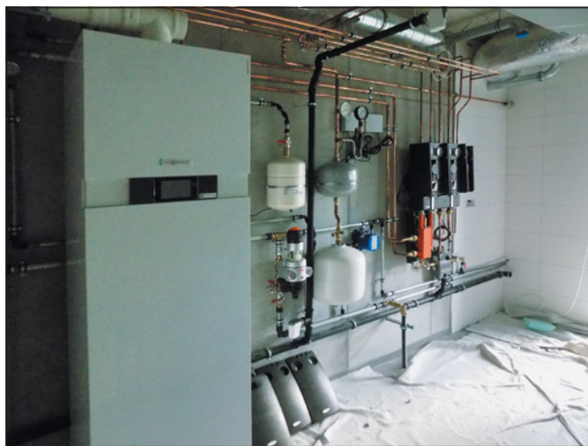
▲ Obr. 2 ● Celkový pohled na kotel a koncentrický vzducho-spalinový systém z plastu
