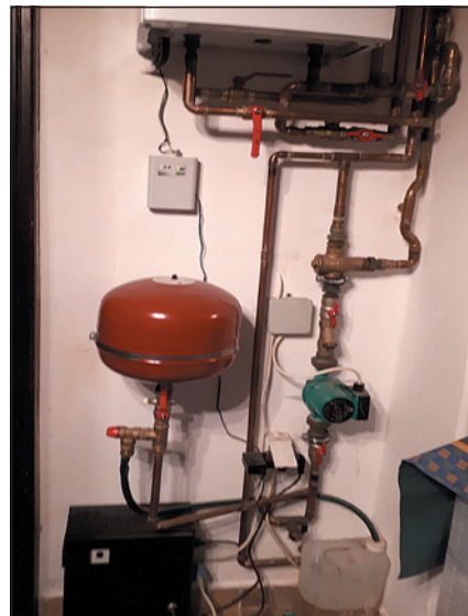
▲ Obr. 2 ● Na zpětné potrubí je osazen pojistný ventil (L2) a uzávěr s vypouštěním 1/4". Mezi uzávěrem a expanzí chybí vypouštěcí a napouštěcí kohout (L10)
