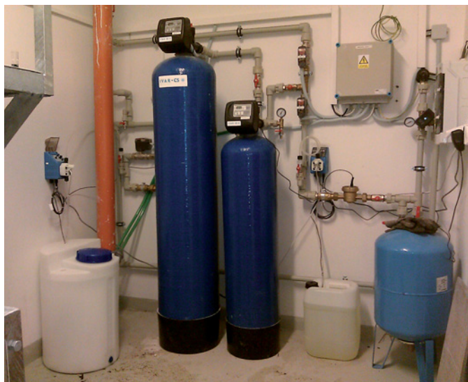
ÚPRAVNA VODY SE SLOUPCOVÝM FILTREM IVAR.DEFEMN
