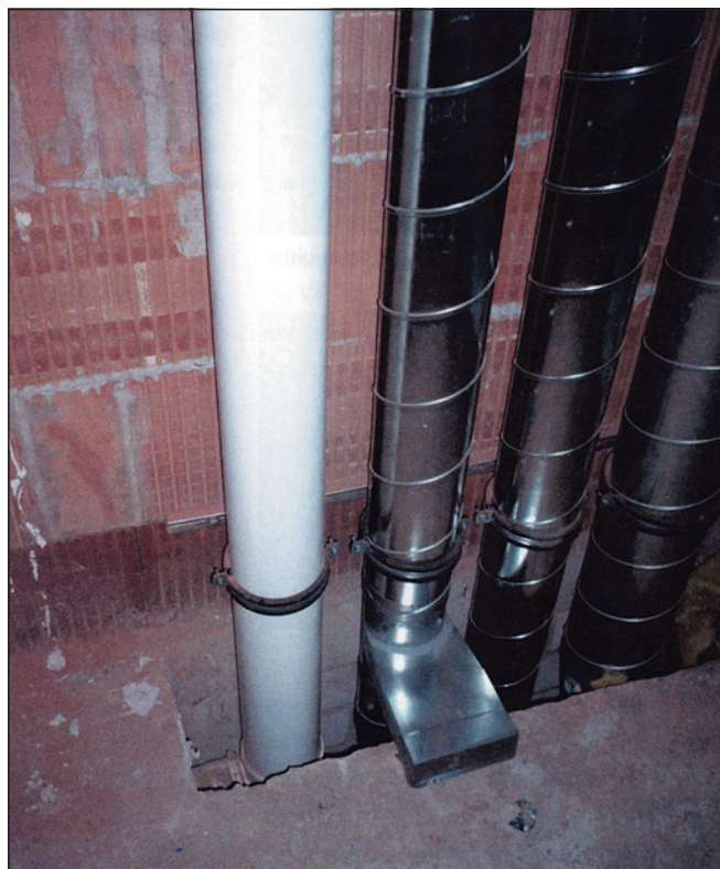
Obr. 11 Při dodržení technických předpisů lze plastový koaxiální spalínový systém vést společnou šachtou. Není však vhodné, aby tato šachta procházela středem bytů, což je naopak výhodné pro potrubí větrací. V šachtě nesmí být plynové a kanalizační potrubí
