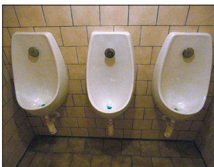
Obr. 5 Chybějící podlahová vpust u veřejných WC
