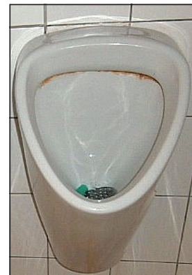
Obr. 13 Usazené nečistoty na povrchu keramiky pisoáru
