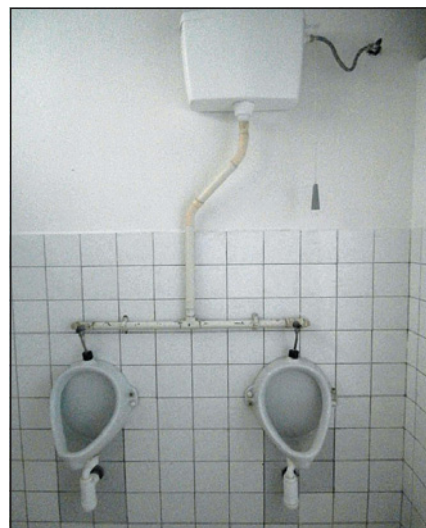
Obr. 8 Nehospodárné splachování pisoárů vysokopoloženou nádržkou
