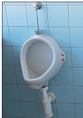
Obr. 12 Pisoár se zápachovou uzávěrkou utěsněnou tmelem
