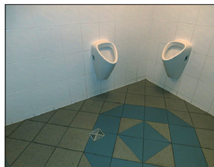
Obr. 3 Špatné rozmístění pisoárů v rohu
