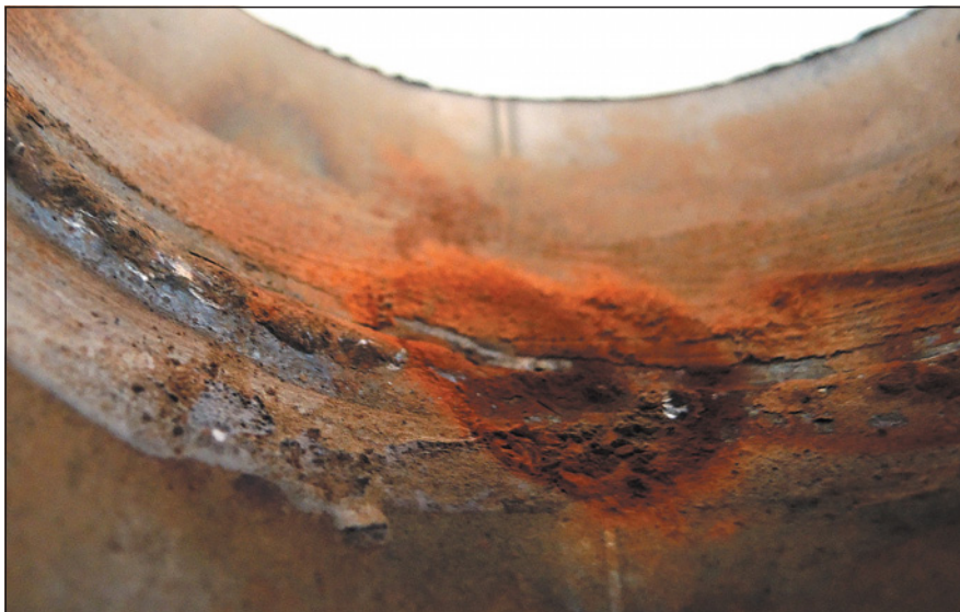
▲ Obr. 2 ● Vnitřní koroze ve svaru ve shodném místě dtto obr. 1
