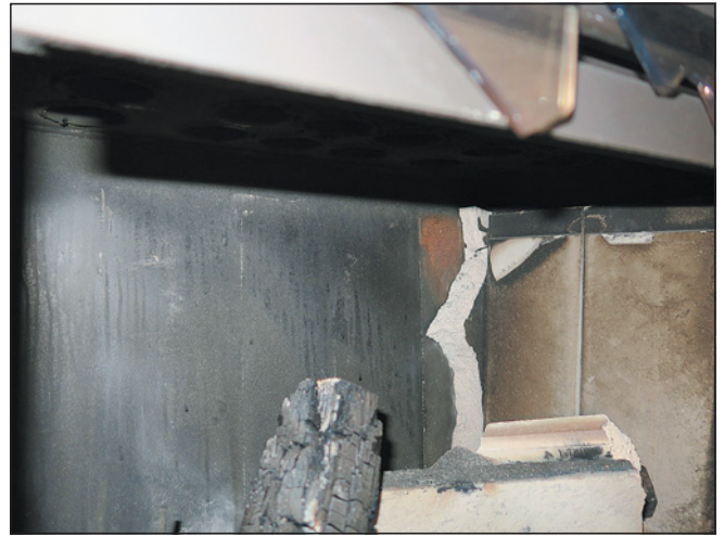
▲ Obr. 5 ● Destrukce obezdění krbu
