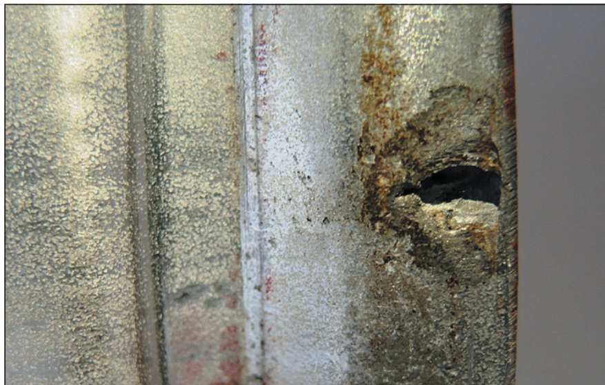
▲ Obr. 5 ● Vnější koroze nejnižší části potrubí, spojování gumovou manžetou a svorkou
