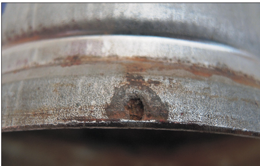
▲ Obr. 3 ● Vnější pohled na prokorodovanou část ve spodní části potrubí, spojovaného gumovou manžetou a svorkou zvenku
