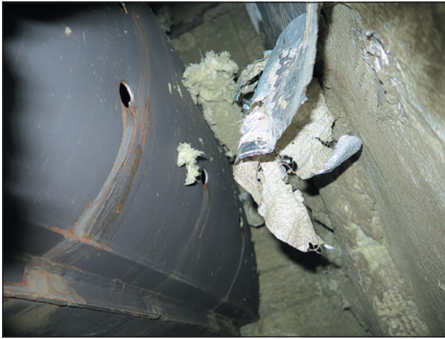
▲ Obr. 4 ● Výměník krbové vložky po destrukci nadměrným přetlakem
