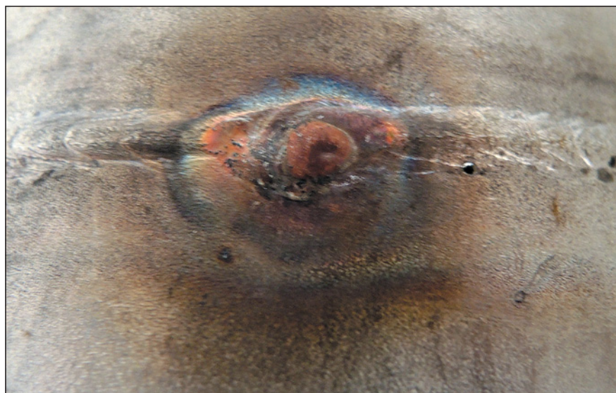
▲ Obr. 1 ● Vnější koroze ve svaru v nejnižší části
