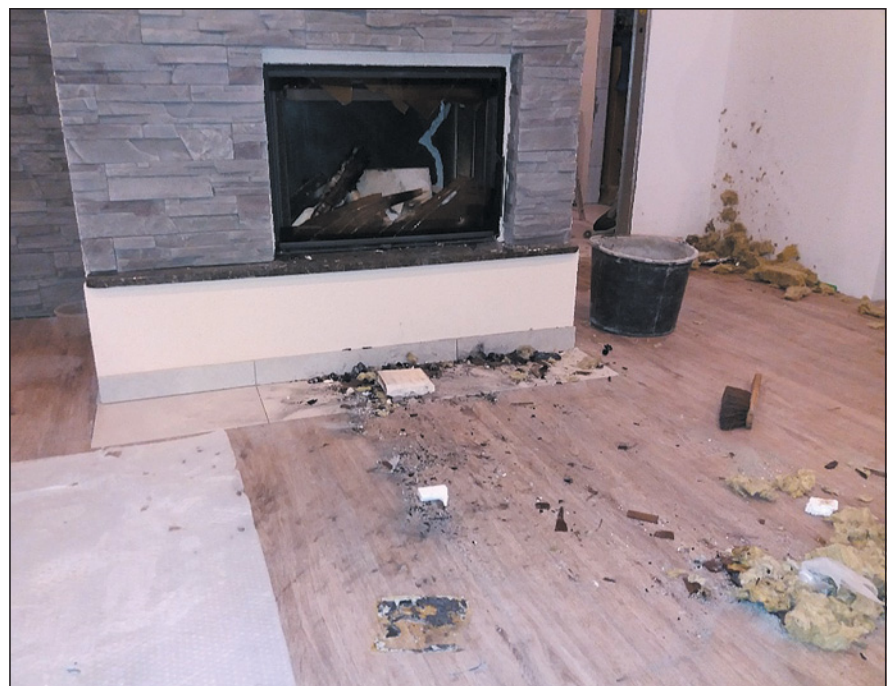
▼ Obr. 3 ● Následky exploze krbové vložky po částečném úklidu
